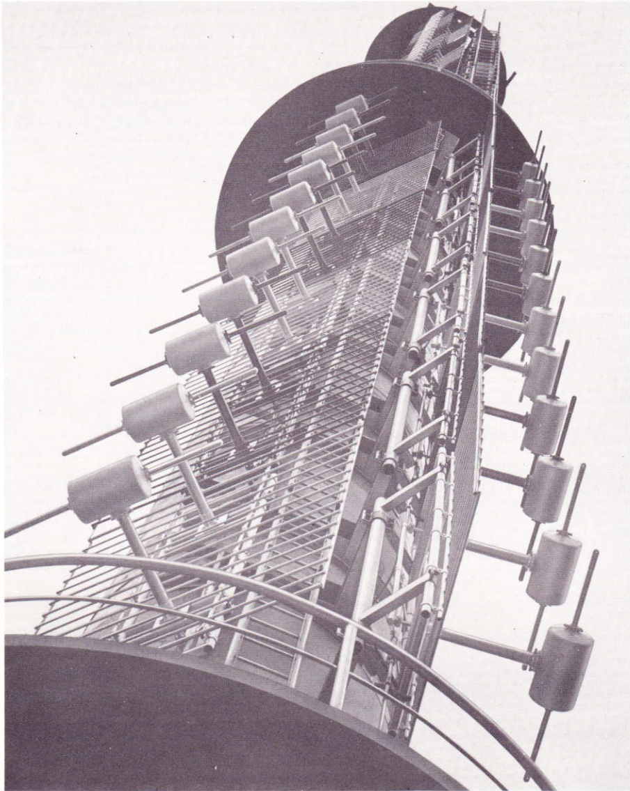
Abb. 1 UKW-Antennenanlage des Österreichischen Rundfunks in Bruck an der Mur (das horizontale Strahlungsdiagramm zeigt Abb. 5)
